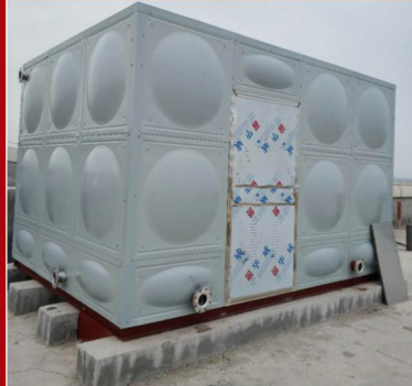
箱泵一体化消防稳压给水设备
