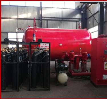
消防气体顶压给水设备
