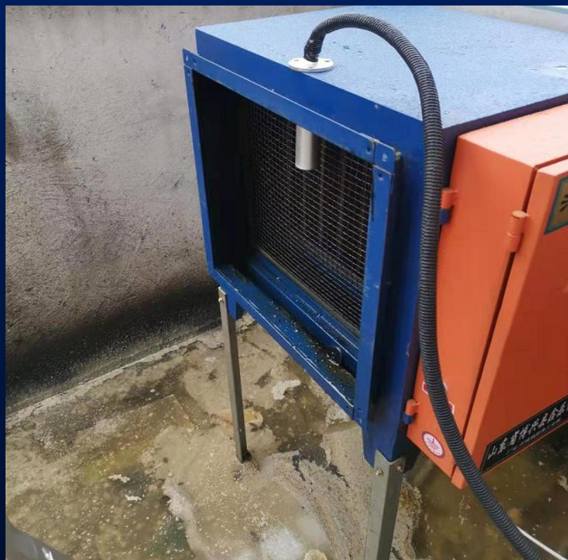
图片为某项目实际安装点位现场情况
