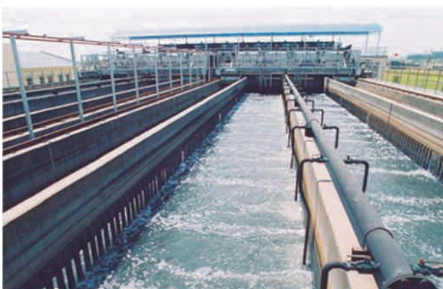
■ 四川德阳污水处理厂项目
