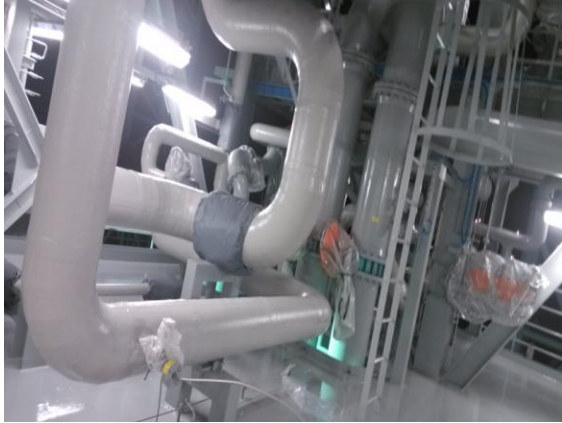
LNG 管道阀门系统
