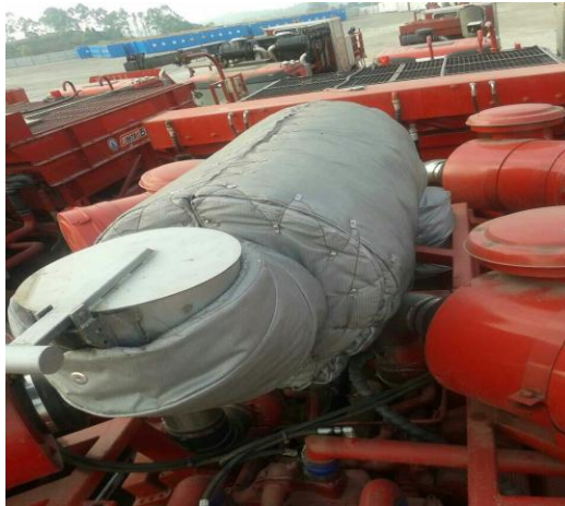
石油设备排气管隔热
