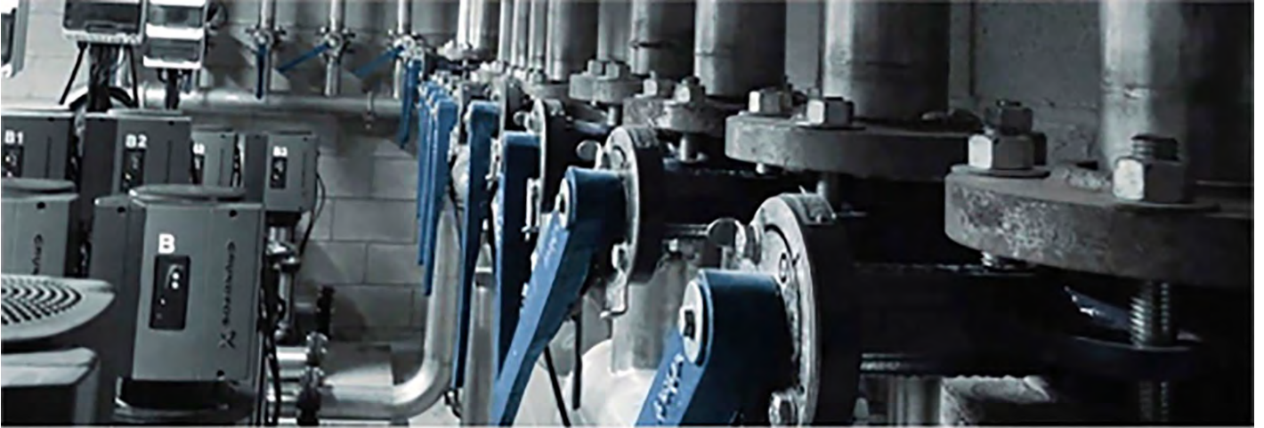
商业建筑的供水设备间。
