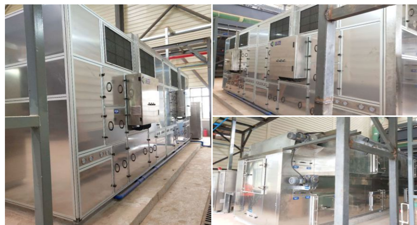
广州（大沙地）净水厂有限公司 污泥类型：市政污泥 前端压滤：板框压滤机 湿泥量：70吨/天 湿泥含水率：45% 干泥含水率：33% 产品型号：JK-LSX9600WN
