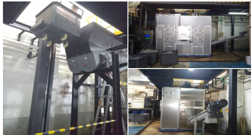
上海纳铁福传动系统有限公司（康桥厂） 污泥类型：电镀污泥 前端压滤：板框压滤机 湿泥量：2吨/天 湿泥含水率：75% 干泥含水率：30% 产品型号：JK-LSX1200WN
