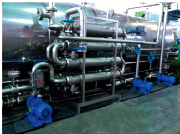
▲ 净水设备工程
