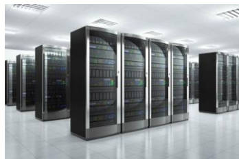
IDC data center IDC 数据中心
