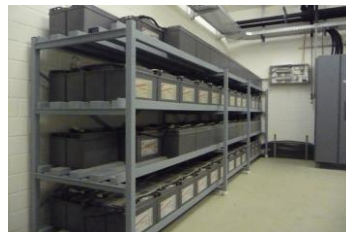
Battery room 电池室
