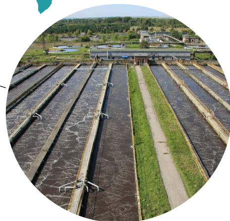
新库兹涅茨克污水处理 厂容量
